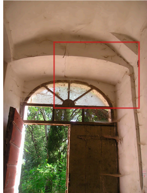
Fig. 7 - riprese fotografica del locale interno con evidenziate le lesioni in prossimità delle volte a botte
