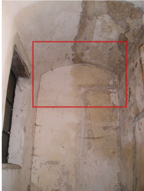
Fig. 6 - riprese fotografica del locale interno con evidenziate le lesioni in prossimità delle volte a botte
