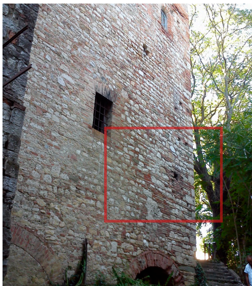
Fig. 3 - ripresa fotografica del prospetto est dell'edificio d'angolo, con evidenziati i rigonfiamenti delle pareti
